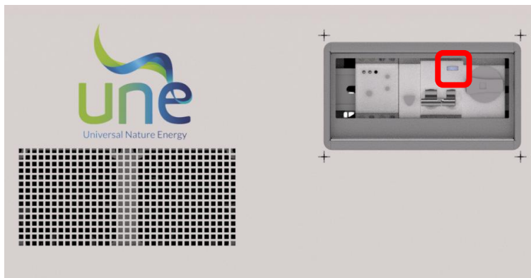
Figura 63 – Quadro ZHERO, pulsante di test protezione magnetotermico differenziale
